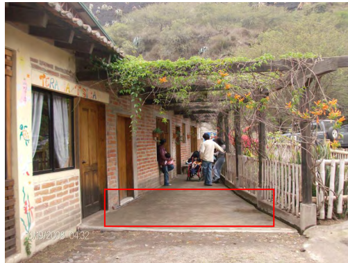
Contrapiso sin ningún recubrimiento en exteriores inmediatos del modulo administrativo.
