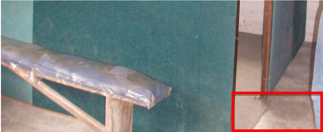
Área de terapias: contrapiso sin revestir en mal estado.
