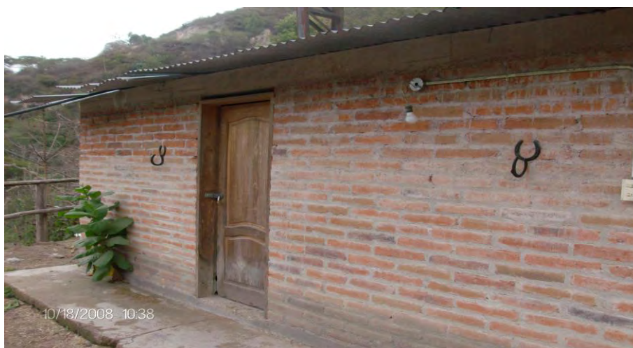
Tipología rústica y en mal estado
