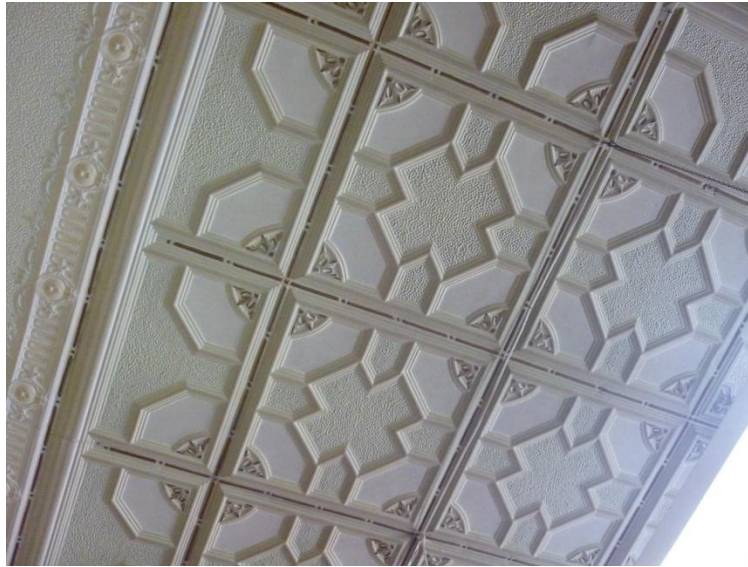
FOTO 1.16 Detalles de cielos rasos en la “Antigua Casa de Pensiones del Seguro Social”
