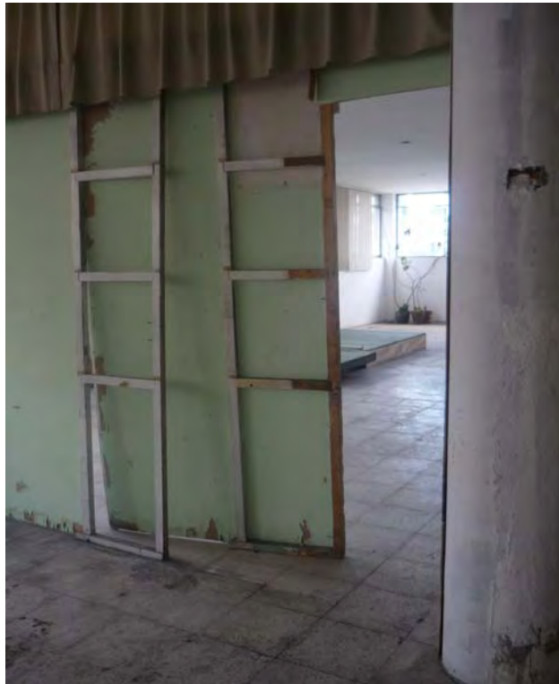
Imagen 1.8.- Módulos divisorios en mal estado
