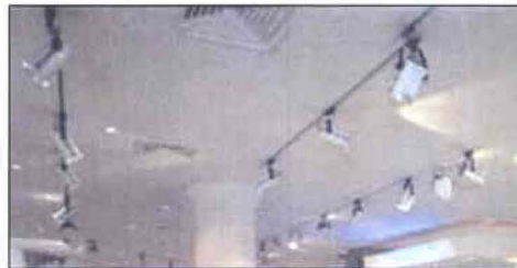
Rieles con dicroicos instaladas alrededor de todo el túnel de cristal para iluminar las obras de la Galería.
