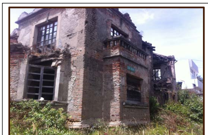
Foto 40: Detalle de deterioro (Lanas, 2014)
