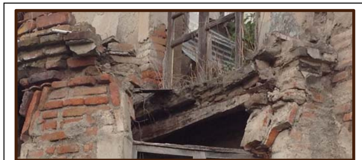
Foto 10: Daños de la edificación (Lanas, 2014)
