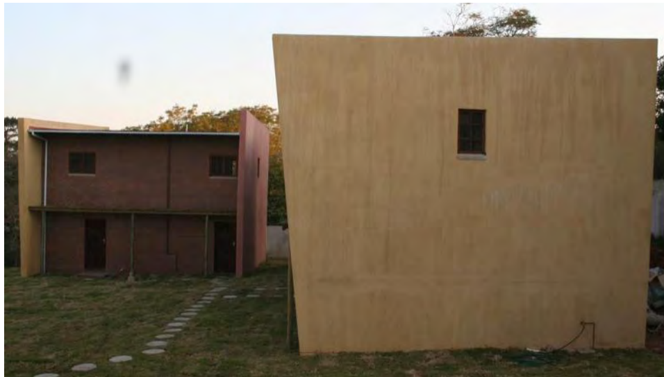
Figura 13. Vista lateral como primer plano y frontal durante el proceso de construcción
