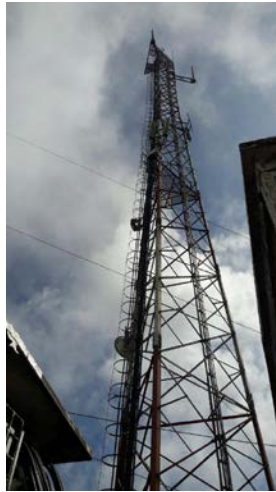
Figura 29. Fotografía panorámica de la Torre Auto soportada SANTA CRUZ N-0
