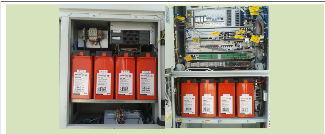
Figura 51. Balcón de Baterías Nodo SFPINOS
