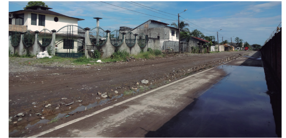
Figura 121. Ciclovía inundada en la calle Amazonas
