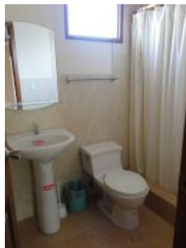
Figura 115. Fotografía del estado actual de baño (bloque 3)
