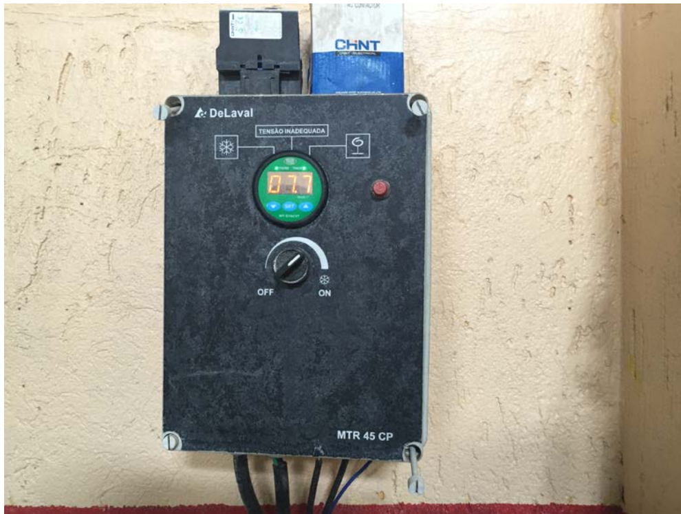
Figura 6. Cuarto medidor de temperatura del tanque de enfriamiento del centro de acopio de La Chimba.
