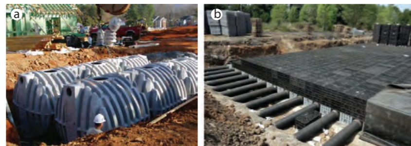
Figura 81. Depósitos de reciclado de agua.
