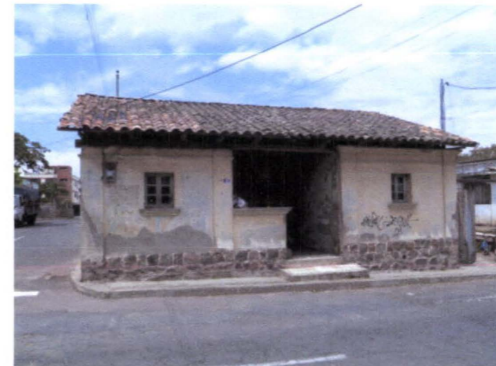
Fotografía 2.6 Casas en mal estado
