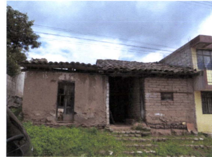
Fotografía 2.5 Casas en mal estado
