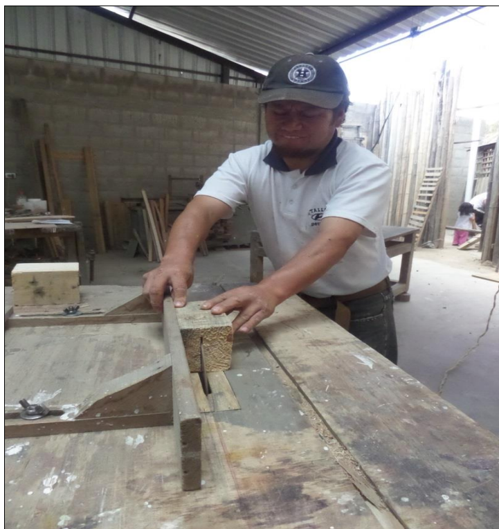
Figura 134. Paso 1: Cortar las tronchas de madera de palet en planchas de 3cm de espesor para obtener las piezas utilizando la sierra de disco.
