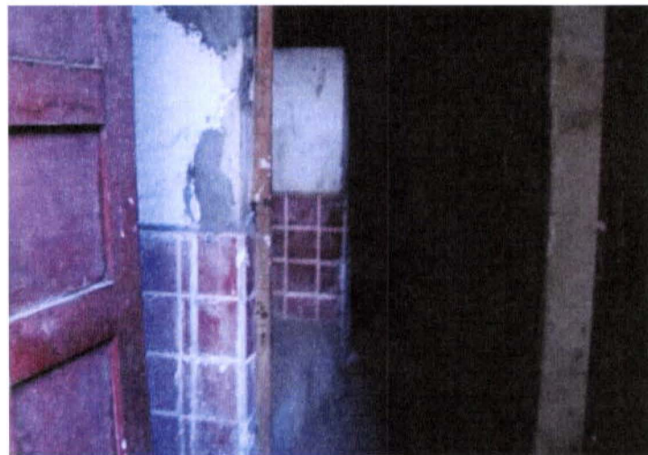
Figura 4 Estado actual de baños dentro del bloque
