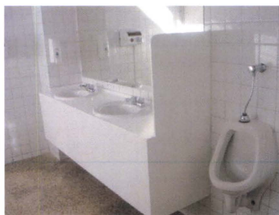
Fig.22. Lavamanos y urinarios Salón
