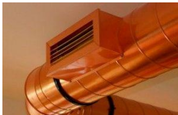
Figura 71. Fotografía de una sección de ducto, ventilación mecánica.
