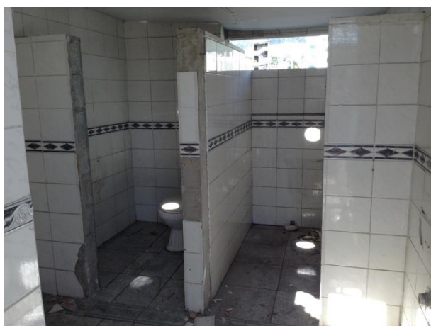
Figura 21. Vista de las baterías sanitarias.
