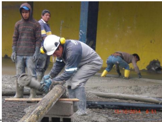
Figura 92. Riesgo de sobre esfuerzo
