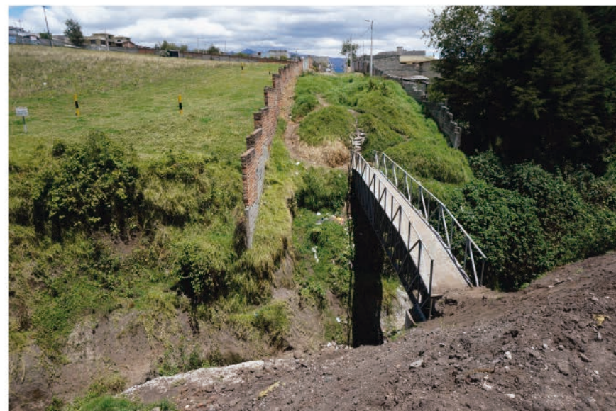
Paso peatonal sobre colector desde barrio Santo Tomás I a hacia barrio San Juan de Guamaní
