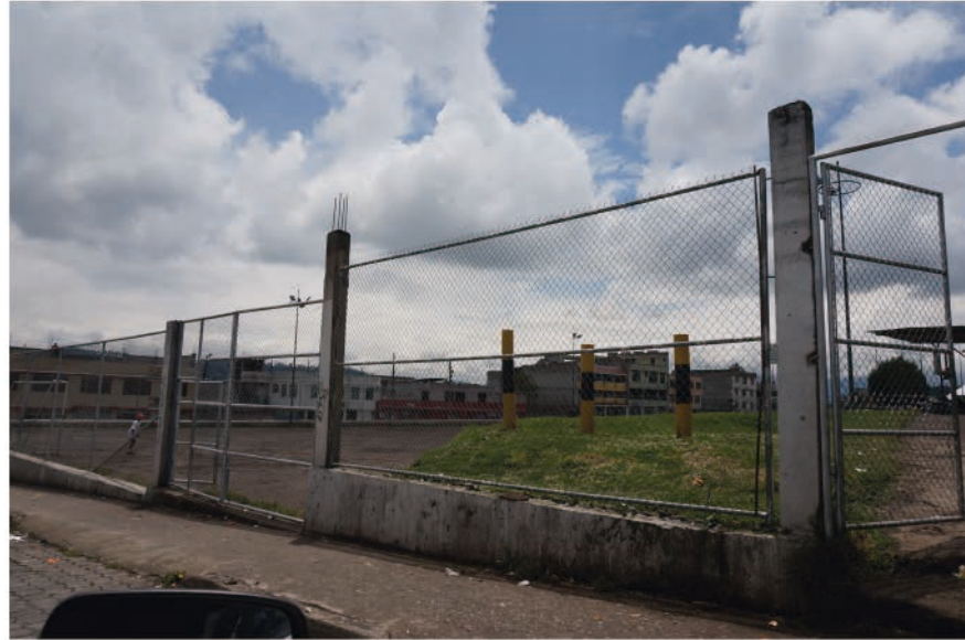
Eje de protección sobre poliducto junto a cancha de liga barrial Sto. Tomás
