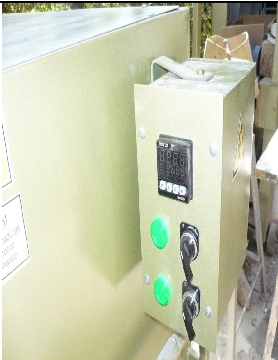
Figura 21. Horno vidrio – panel eléctrico
