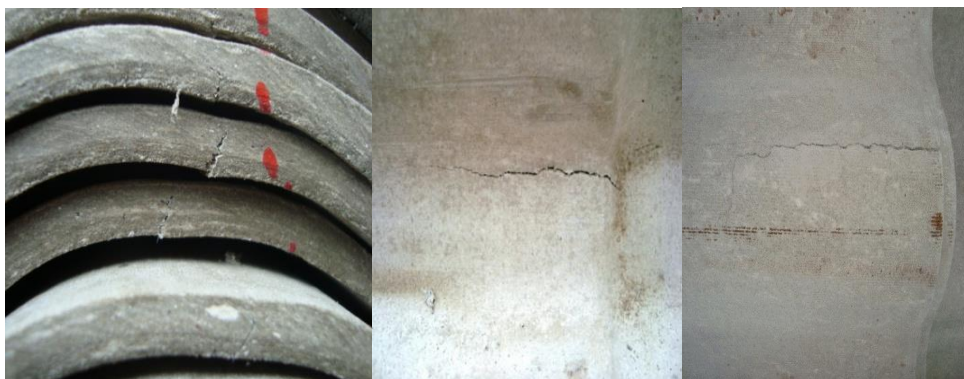
Figura 40. Ejemplos de Fisura Longitudinal Parcial
