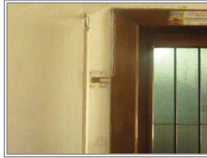
Figura68. instalaciones eléctrica y datos internas
