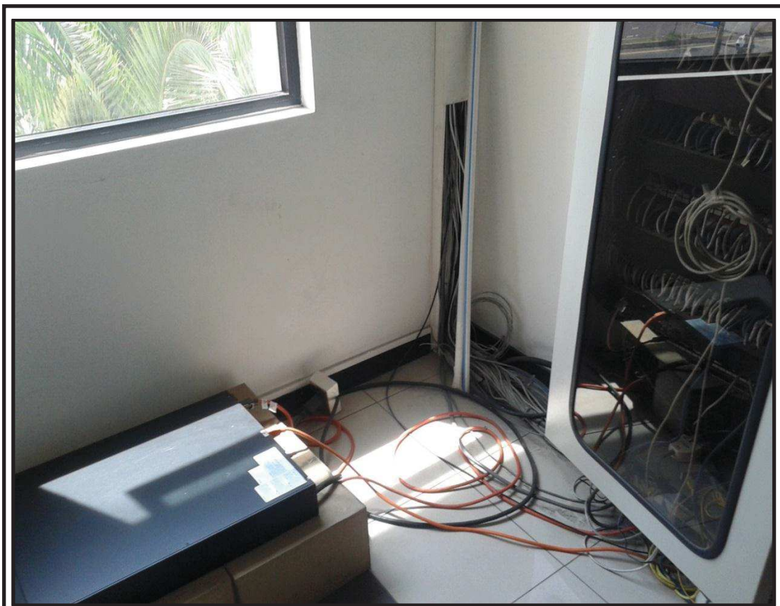
Figura 28 Cuarto de quipos Centro médico Los Chillós
