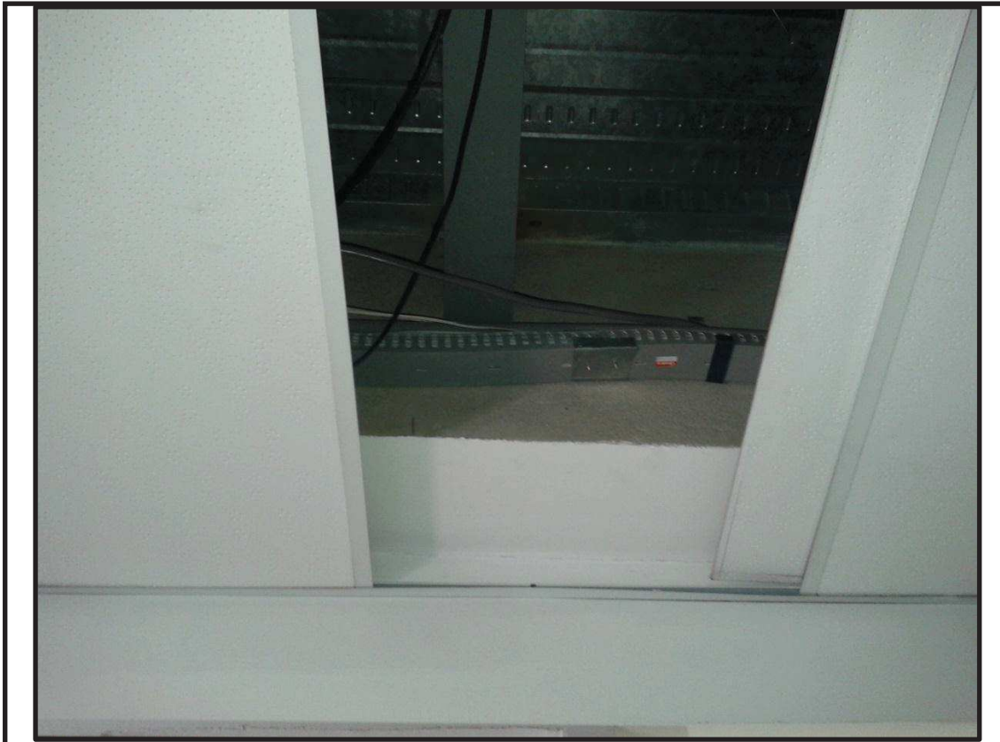
Figura 38 Centro Médico Los Chillos Canalización metálica
