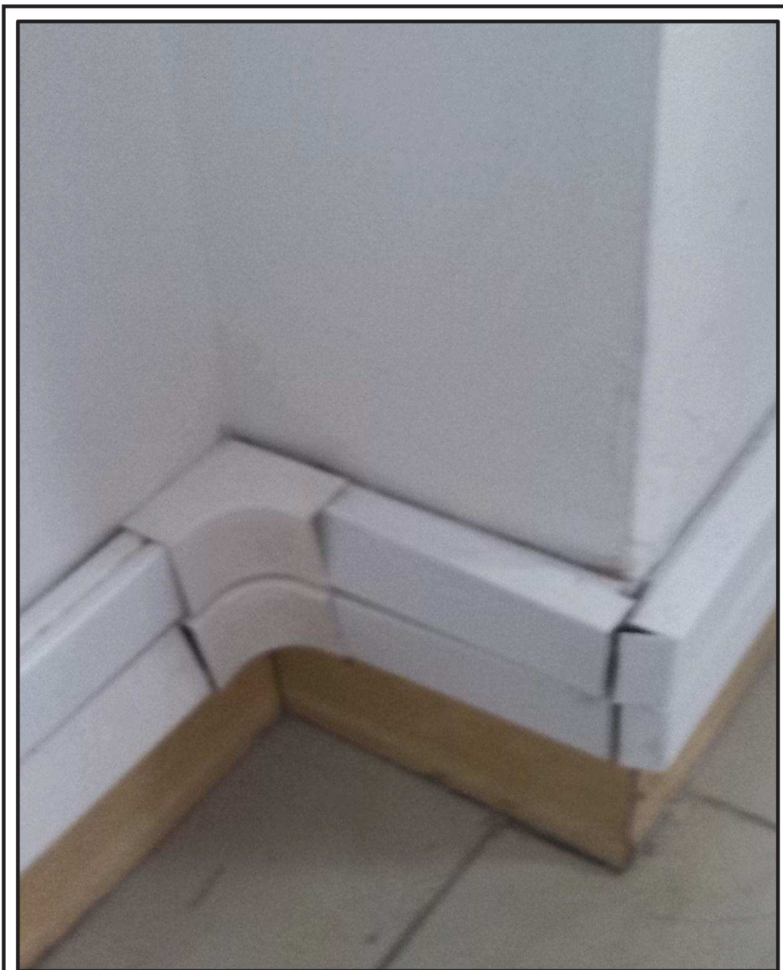
Figura 34 Centro Médico Carolina Canalización por pared
