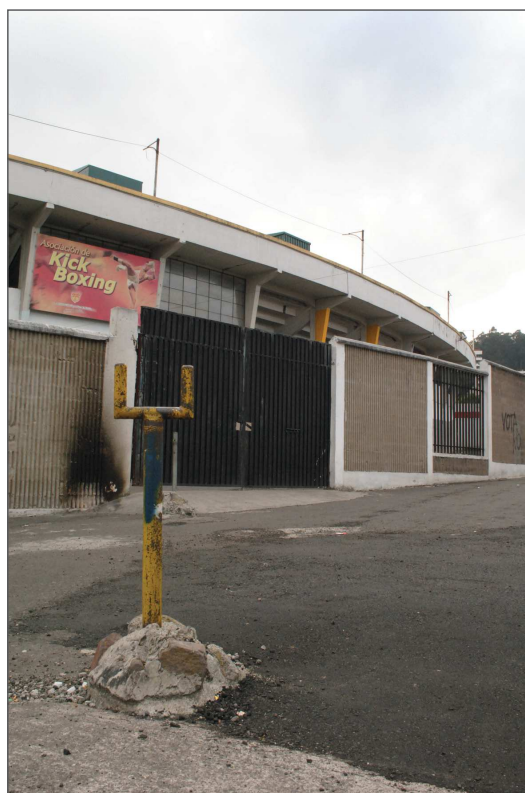
Figura. 90. Estadio Olímpico Atahualpa, elementos en mal estado. Fotografía, David Pavón.
