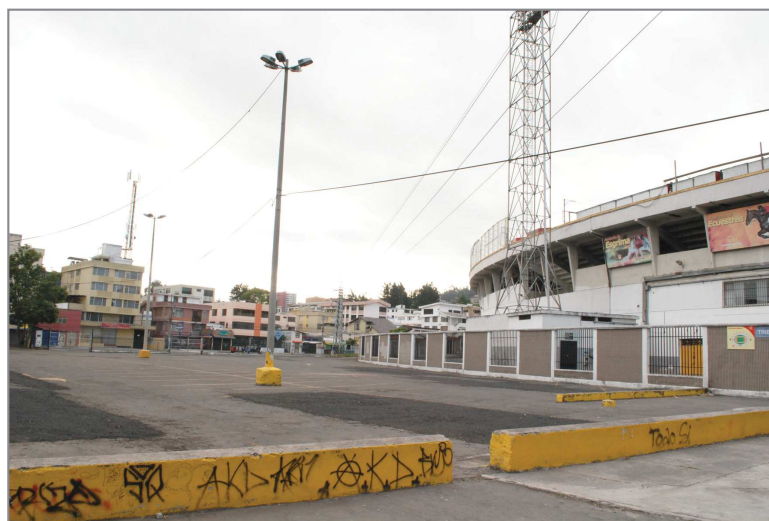
Figura. 88. Estadio Olímpico Atahualpa, deterioro evidente. Fotografía, David Pavón.
