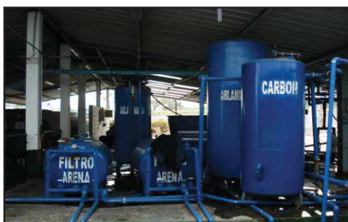
FIGURA 1.19 PLANTA DE TRATAMIENTO DE AGUA
