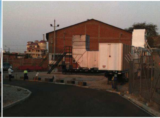
Zona de filtros Turbina
