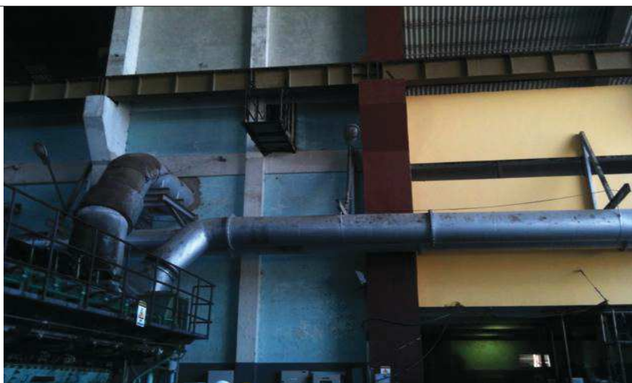
Figura 36. Lugar de instalación de la cortina acústica
