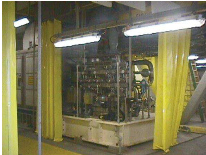
Figura 35. Fotografías ejemplo de una cortina acústica instalada
