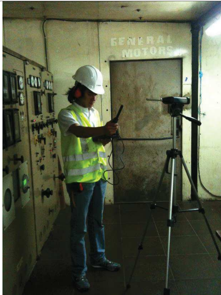
Figura 53. Cuarto de control de unidades 10 y 13 (estado inicial)
