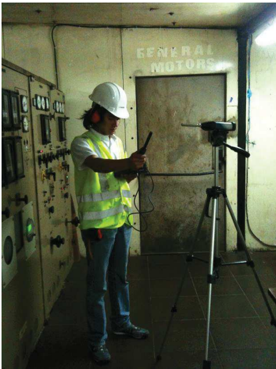
Control Room unidades. 10 y 13
