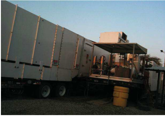
Ingreso a turbina
