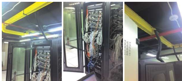
Ilustración 107 - Ductería y llegada a Equipos
