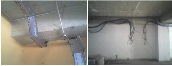
Ilustración 94 - Paso de Ductería evadiendo columnas
