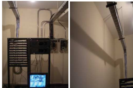
Ilustración 108 - Ductería y llegada a Seguridad
