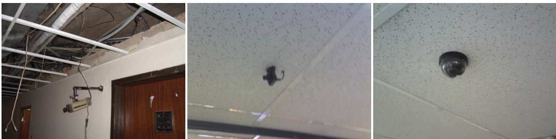
Ilustración 99 - Cámaras de Seguridad
