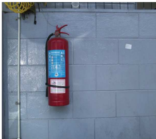
Figura 5. Extintor sin señalización
