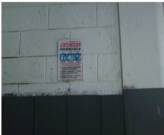
Figura 7. Señalización antigua, sin mantenimiento y mal ubicada
