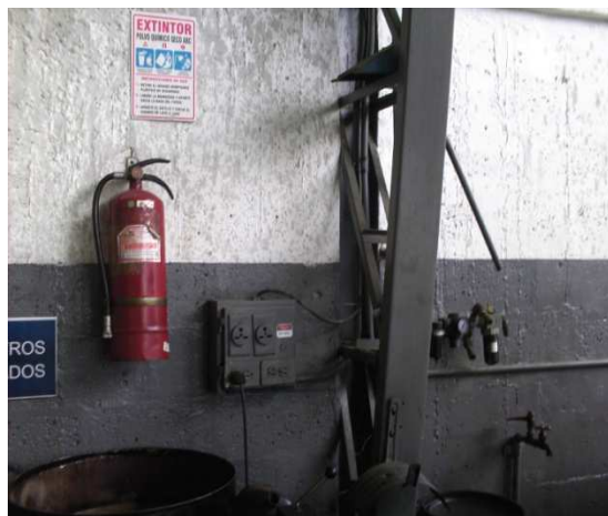
Figura 6. Extintor mal ubicado
