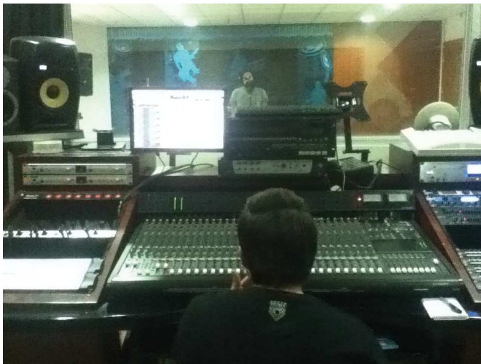
Anexo 65. Fotografía del Control Room.
