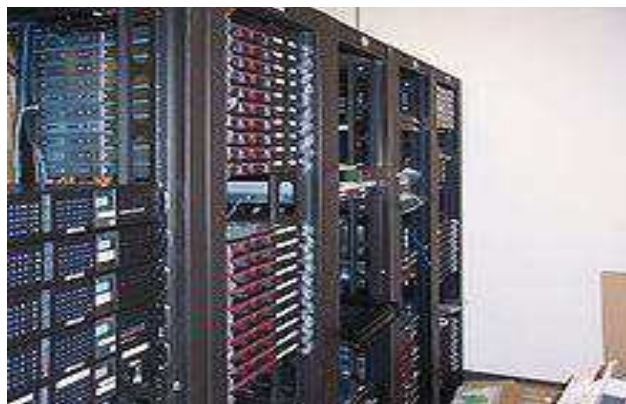
Servidor de almacenamiento
