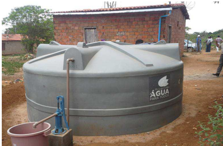
Figura 18: Cisterna de polietileno
