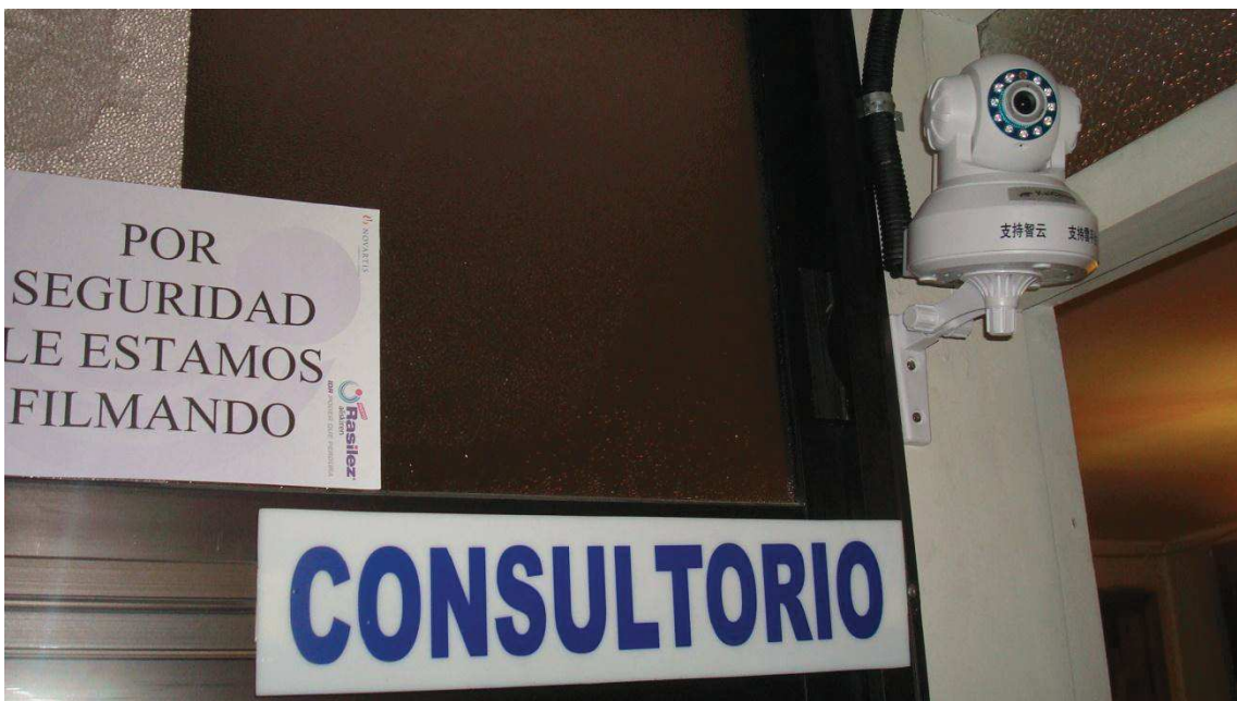
Cámara en Pasillo (Hall)
