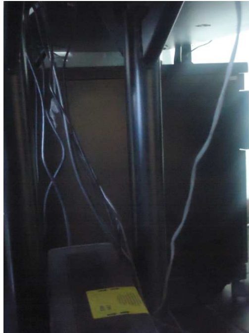
Figura 52. Cable telefónico del área Control de Calidad
