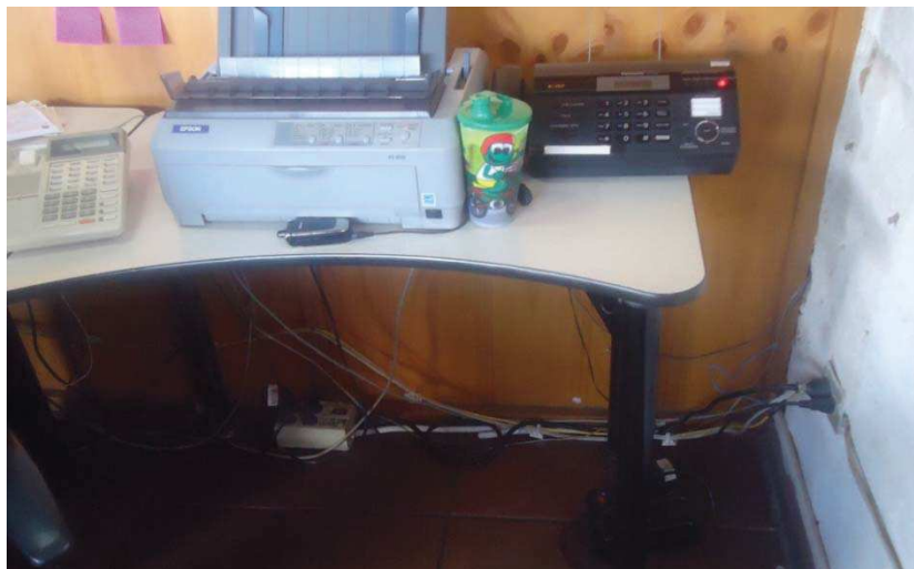
Figura 50. Cables telefónicos desordenados Administración
