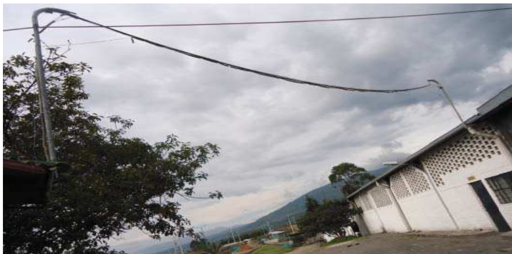
Figura 43. Cable aéreo de Administración a Producción
