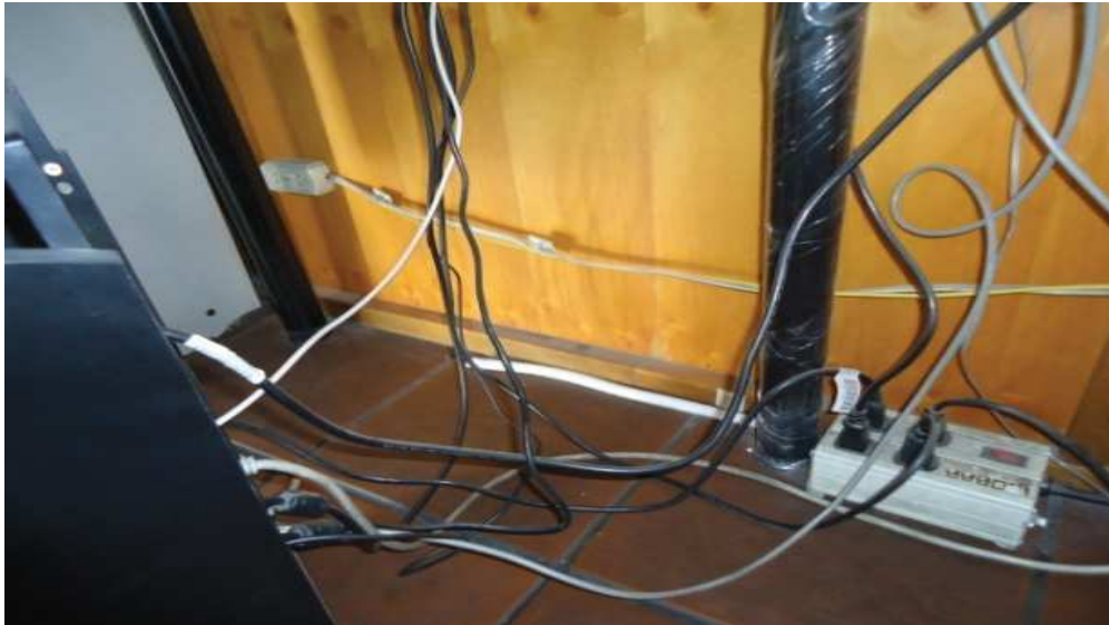
Figura 45. Cable eléctrico junto a cable de datos
