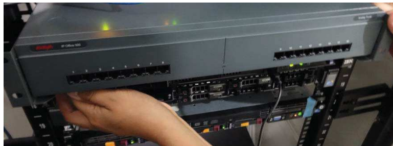
Figura 31. Montaje en rack de módulo de expansión
