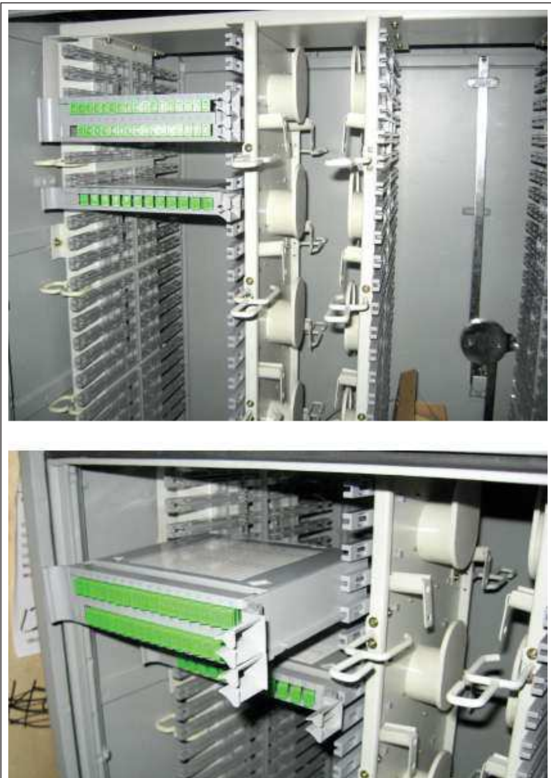
Figura 30. Armario FTTH con Splitters y bandejas de fibra instaladas. Tomado de: CNT, capacitación Noviembre de 2012. Normativas de construcción.
