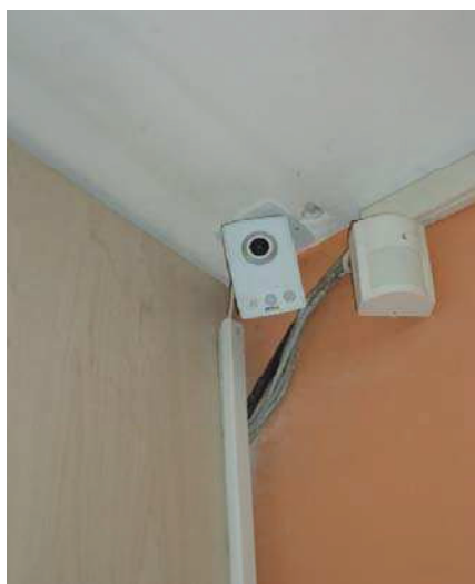
Figura 39 Cámara inalámbrica ubicada en Dpto. Técnico
