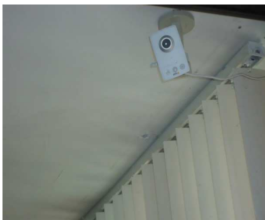
Figura 40 Cámara inalámbrica ubicada en Recepción.
