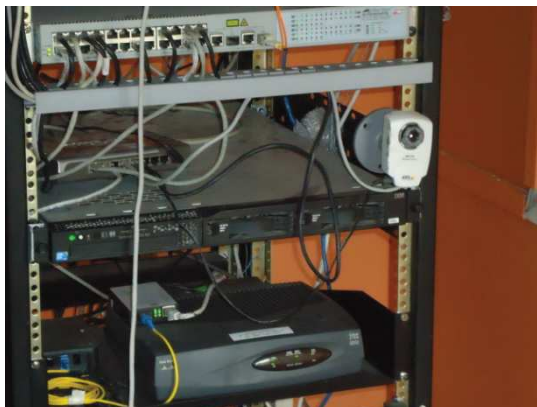
Figura 47 Cámara fija ubicada en Data Center.
