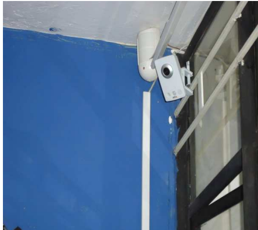
Figura 41 Cámara inalámbrica ubicada en Bodega.
