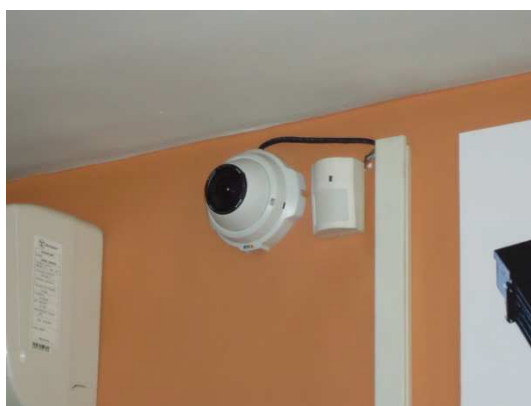
Figura 45 Cámara PTZ ubicada en la sala de reuniones.
