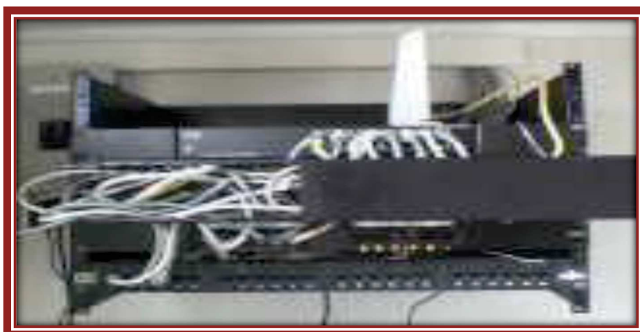
Fig.2.5 Cuarto de equipos de Carolina Construcciones.
