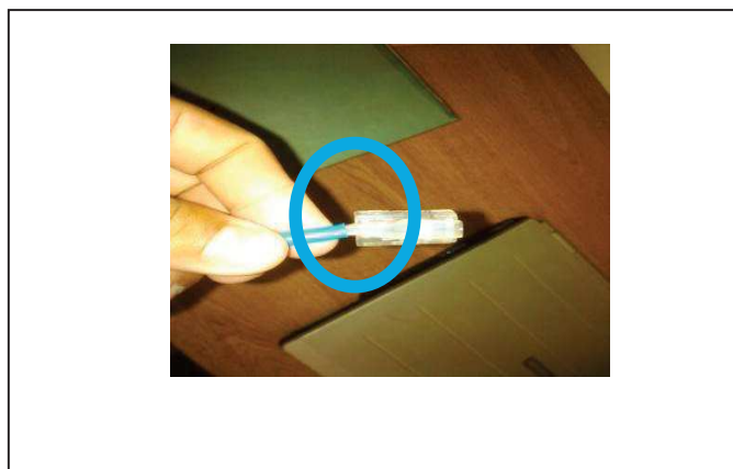
Fig.25 Cable en malas condiciones
