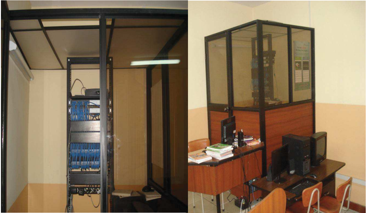
Anexo 13. Cuarto de telecomunicación visto por fuera.
