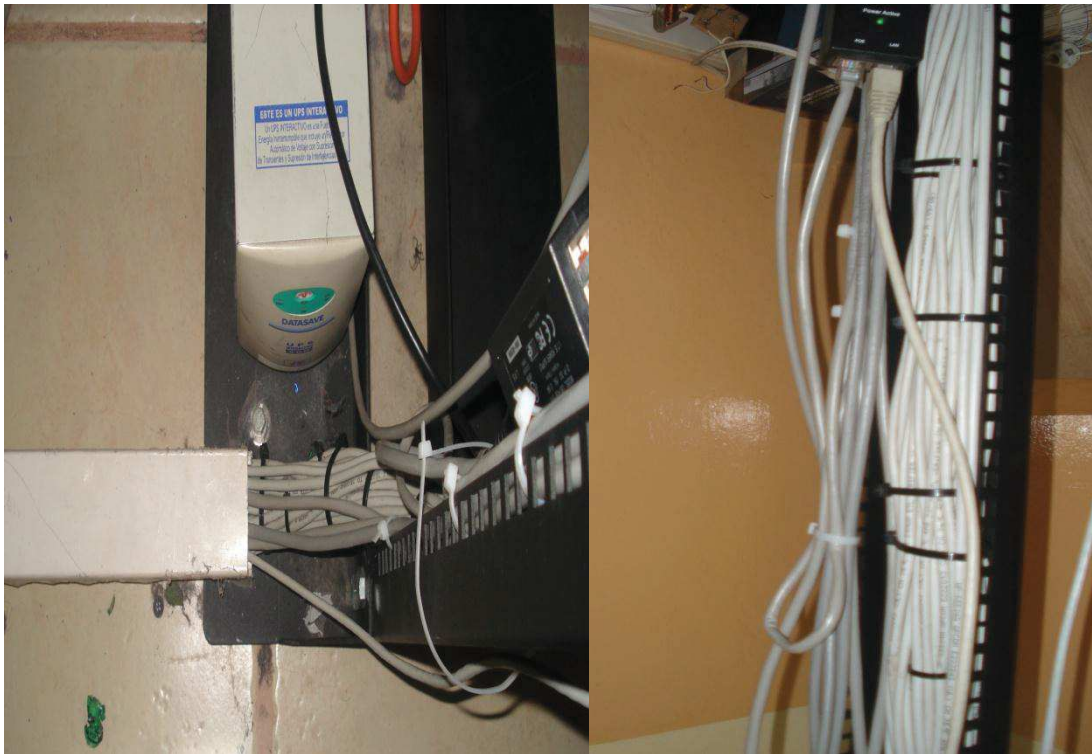
Anexo 7. Se organizó el cableado con amarras hacia el mueble del cuarto de equipos.
