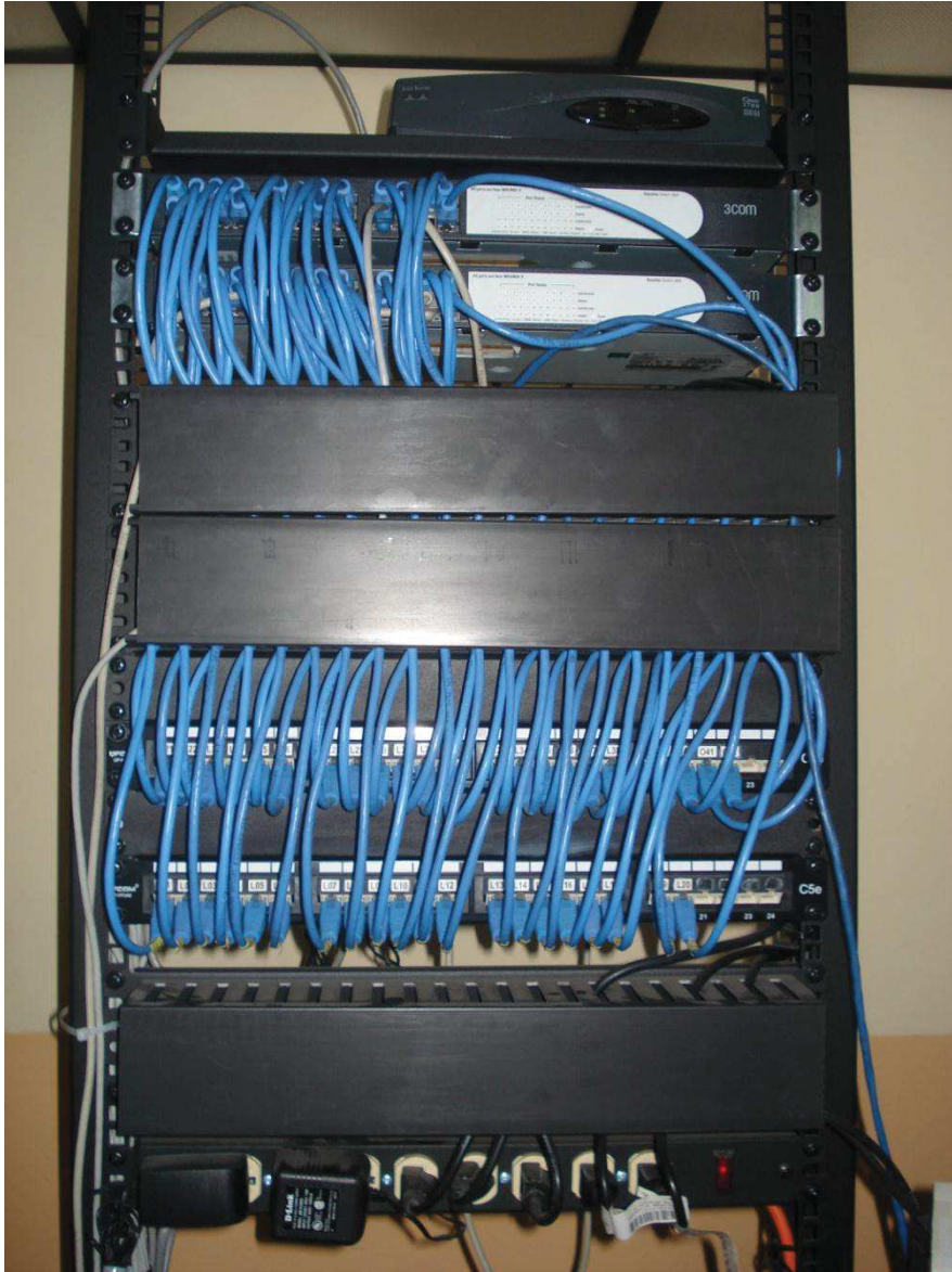
Anexo 12. Se organizó de forma completa del rack en el cuarto de telecomunicaciones.
