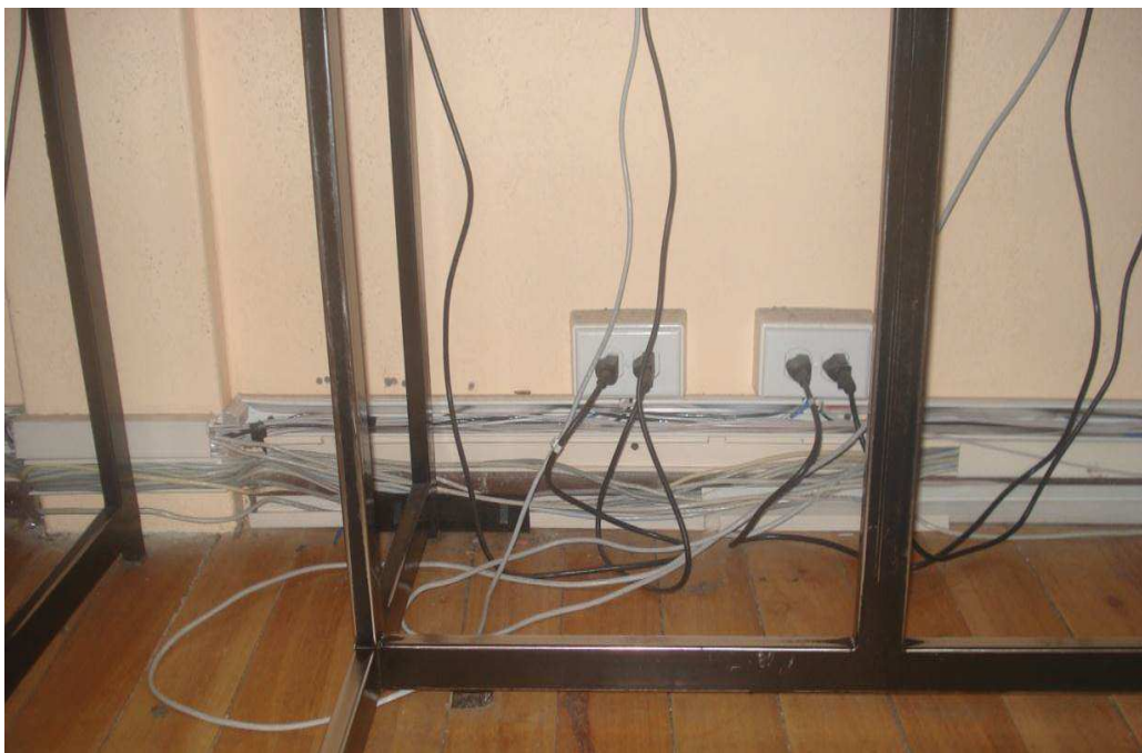
Figura 10. Cableado de datos en mal estado.
