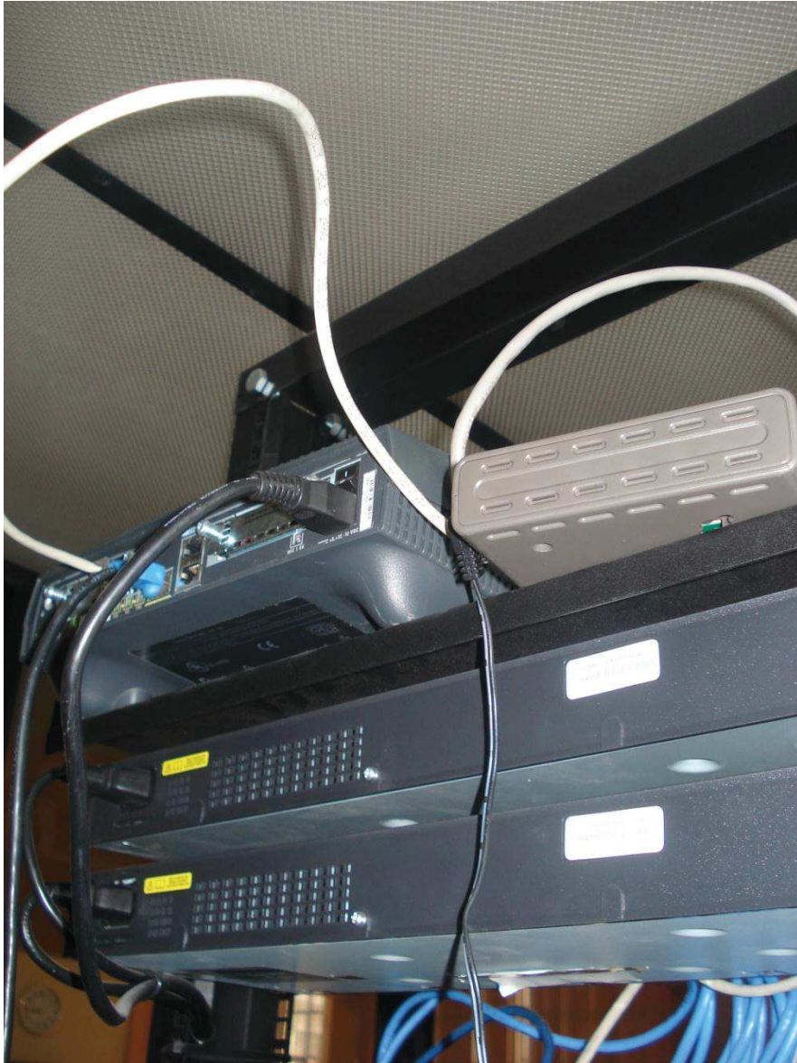
Anexo 9. Se colocó los switch y router en el rack.
