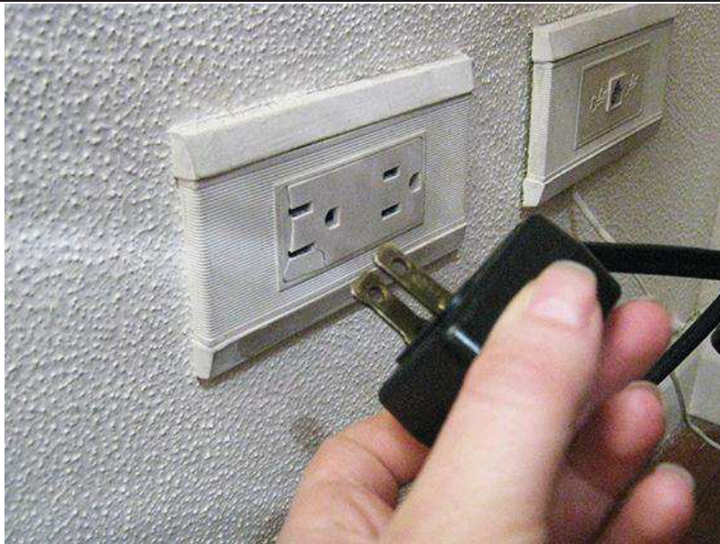
Figura 9. Desconectar aparatos eléctricos
