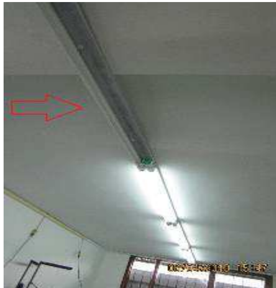
Figura 16. Iluminación insuficiente en el área de maquinas
