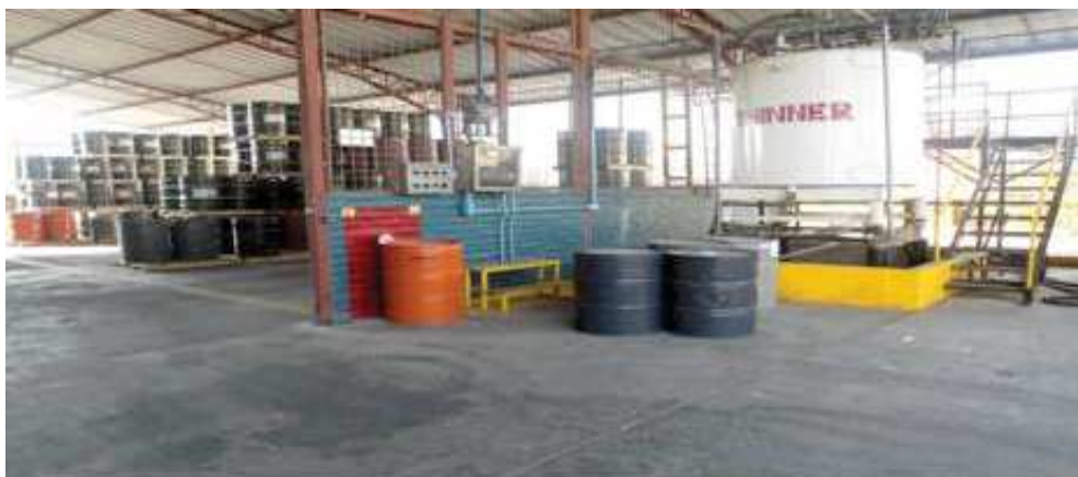
FIGURA 21. PLANTA DE DILUYENTES SU FABRICACIÓN Y ENVASADO PINTURAS CONDOR
