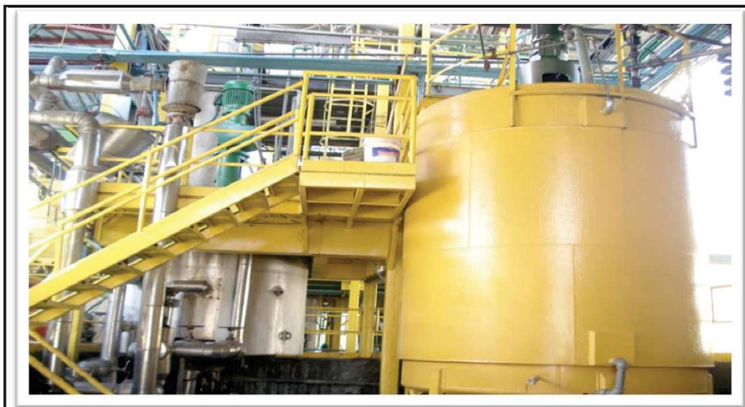
FIGURA 8. PLANTA DE RESINAS
