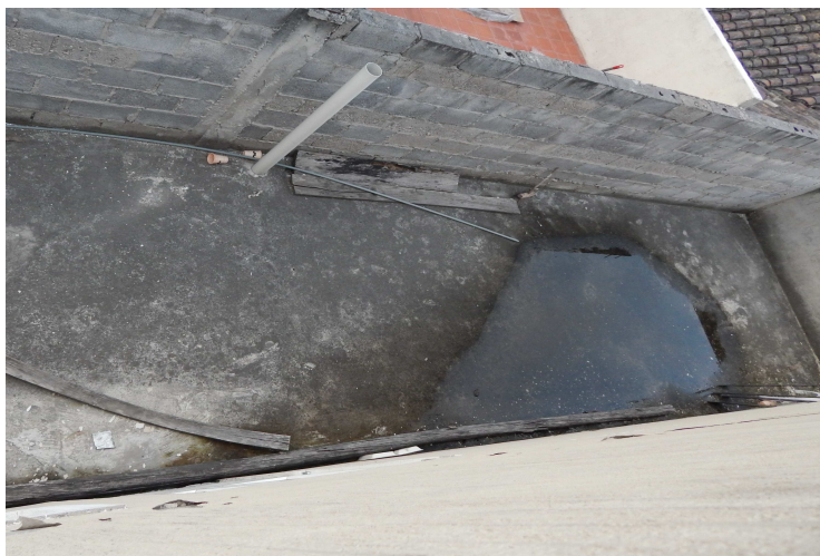
Figura 47. Terraza inaccesible primer piso
