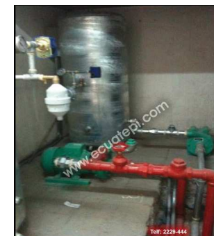
Tanque hidroneumático para sistema de incendios.
