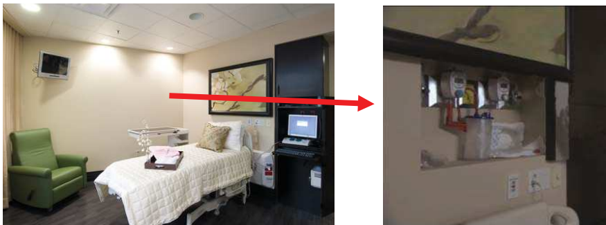
a) Tomas de oxígeno, aplicación de sueros y elementos para control médico ubicado detrás del cuadro.
