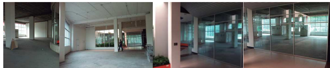
LOCALES COMERCIALES EN DESUSO
