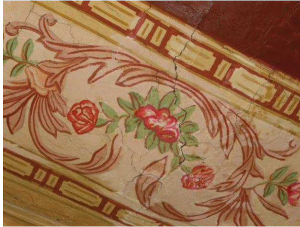
Figura 45. Fisura Cielo Raso
