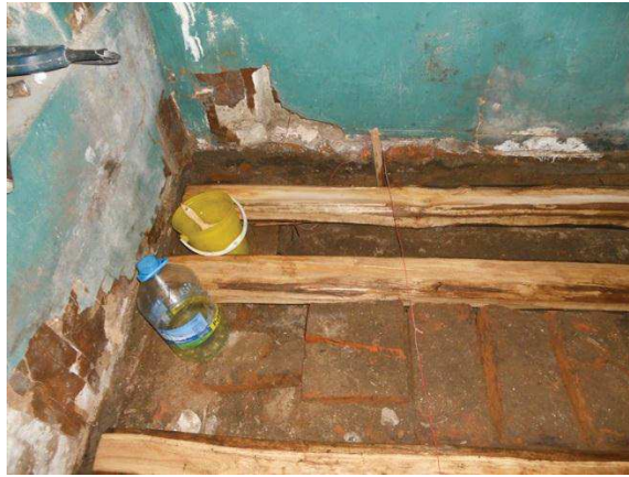
Figura 47. Deterioro y cambio de pisos en planta baja
