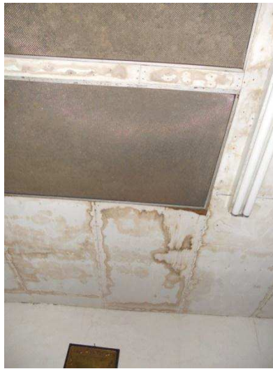
Figura 48. Humedad En Cielo Raso
