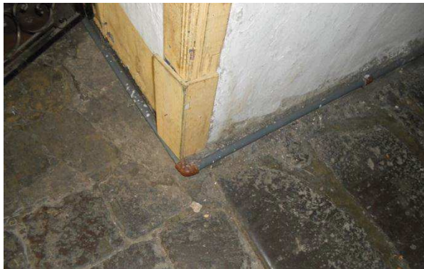
Figura 50. Instalaciones por el exterior de las paredes
