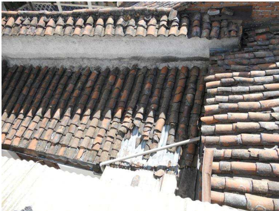
Figura 42. Cubiertas en mal estado
