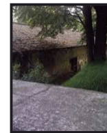
Figura 18. Desnivel de la casa
