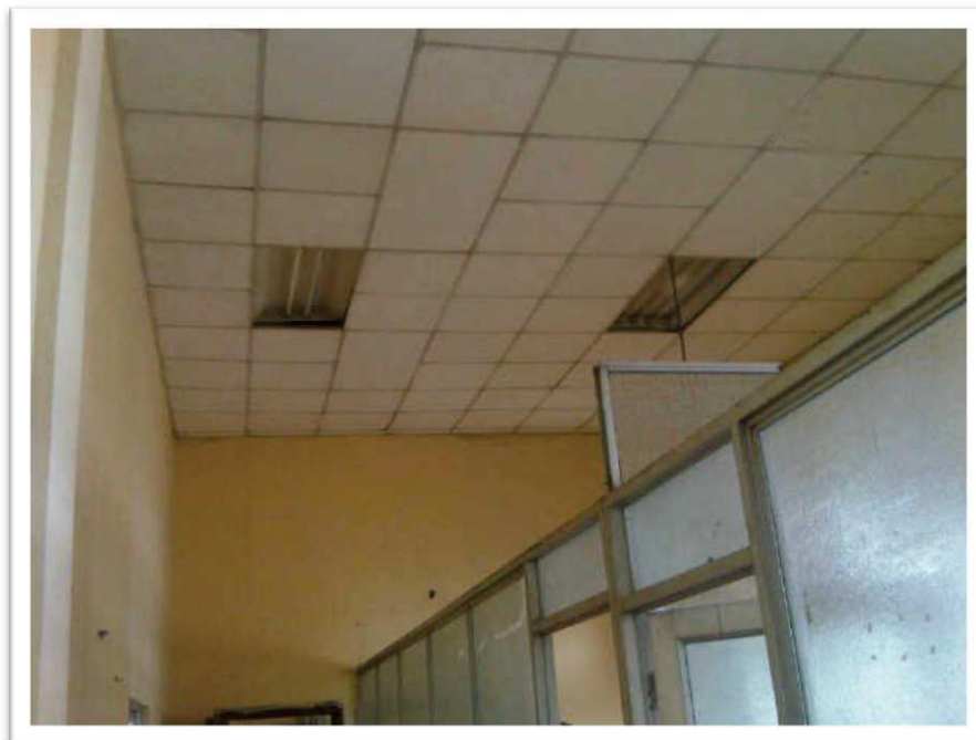
Figura 56. Luminarias sala de taller
