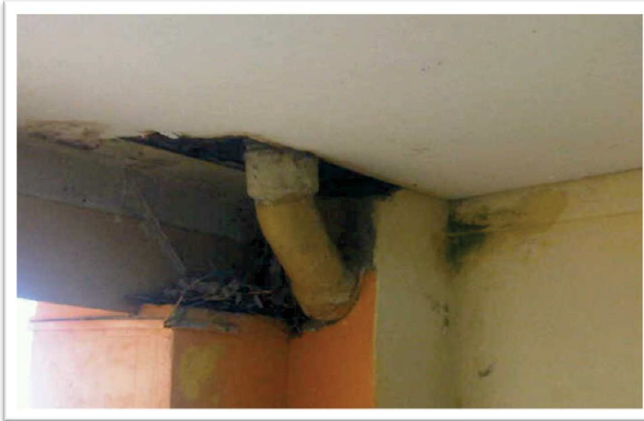
Figura 52. Tubería de aguas servidas
