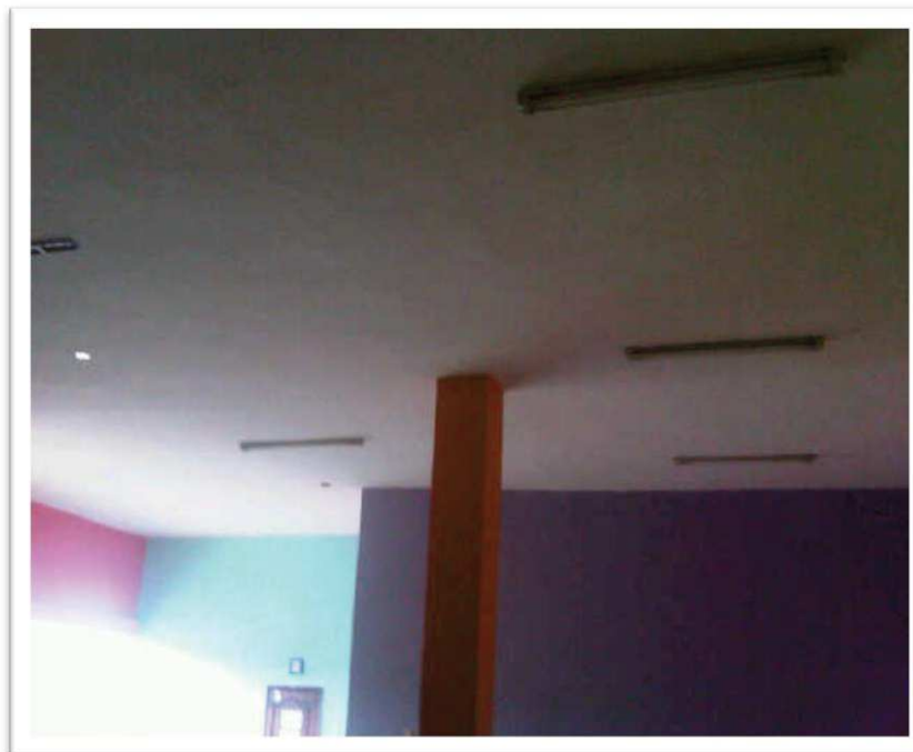
Figura 57. Luminarias sala de taller
