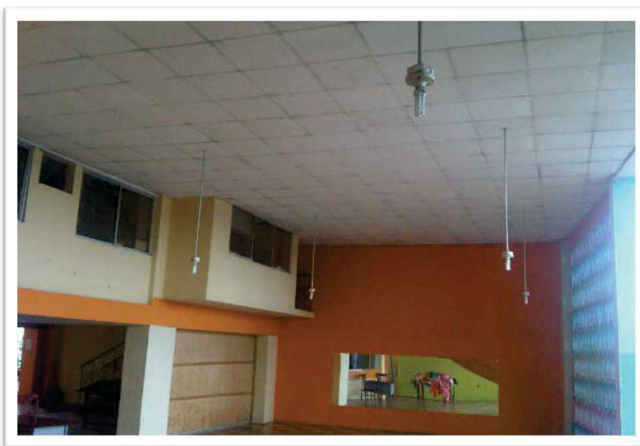
Figura 55. Luminarias – sala de taller
